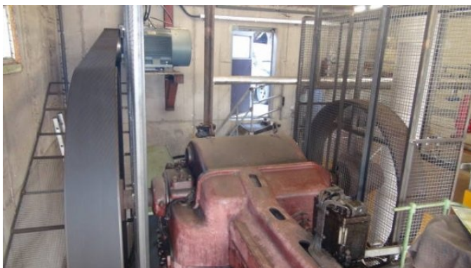
Dampfmaschine mit Generator, Elztäler Mineral
